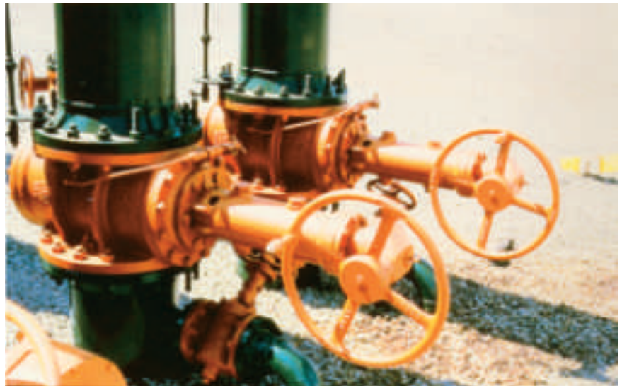
Les réseaux de carburant enfouis nécessitent des tests de pression réguliers
