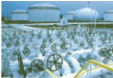
Bac de stockage
